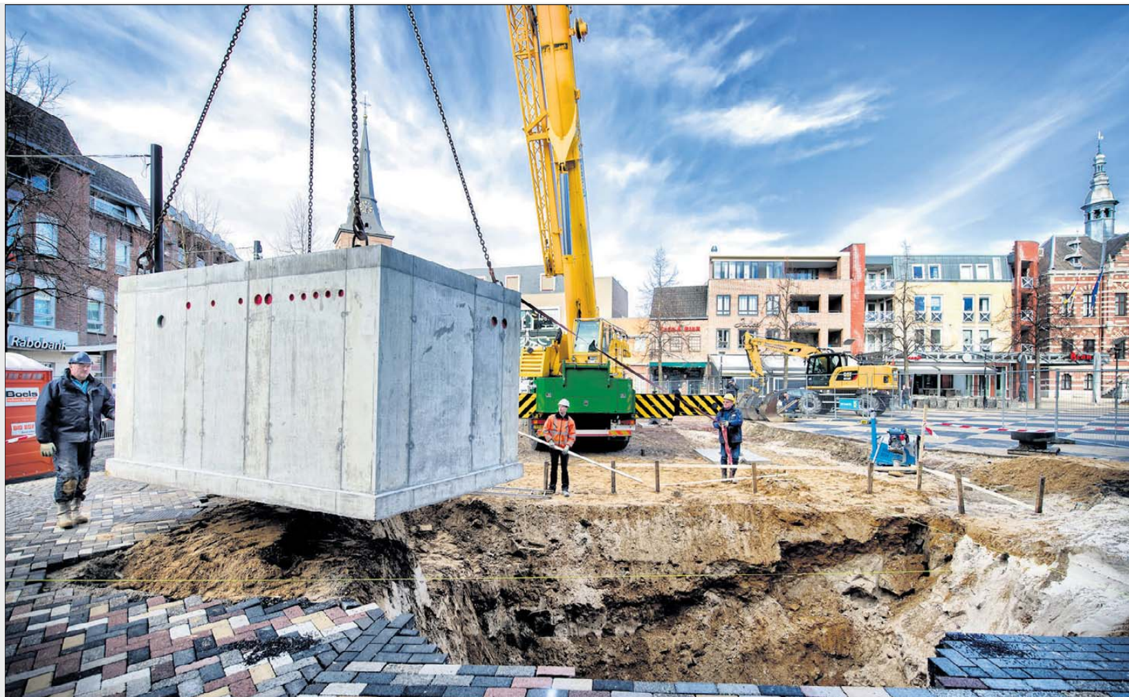
De betonnen bak van de nieuwe fontein wordt in de kuil op de Markt gemanoeuvreerd.
